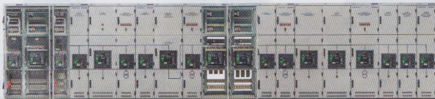
Eine 4000 A VAMOCON Niederspannungsschaltanlage mit Leistungsschaltern von Schneider Electric sorgt in einer Ölmühle für eine moderne Energieverteilung
