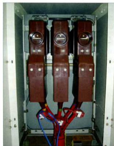
Bild 2: Die Stromversorgung wurde vom gelöschten 10-kV-Netz auf das niederohmige 10-kV-Netz der Netzdienste Rhein-Main umgestellt.
