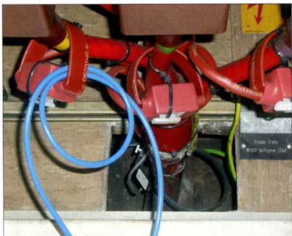
Bild 3: Kries-Energietechnik lieferte die Produkte zur Optimierung der Schutzfunktionen und selektiven Fehlerortung im Netz. Im Bild ist die Simulation einer Störung zu Prüfzwecken installiert (blaue Leitung induziert einen Überlast-Primärstrom in den Kabelumbauwandler L1 des IKI-30).
