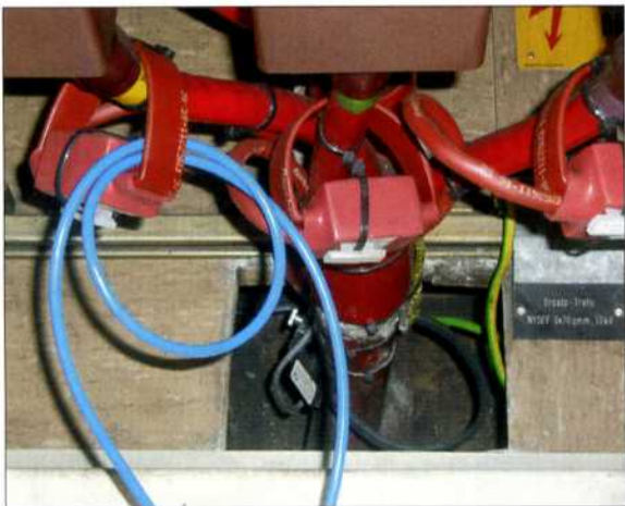
Bild 3: Kries-Energetechnik lieferte die Produkte zur Optimierung der Schutzfunktionen und selektiven Fehlerortung im Netz. Im Bild ist die Simulation einer Störung zu Prüfzwecken installiert (blaue Leitung induziert einen Überlast-Primärstrom in den Kabelumbauwandler L1 des IKI-30).
