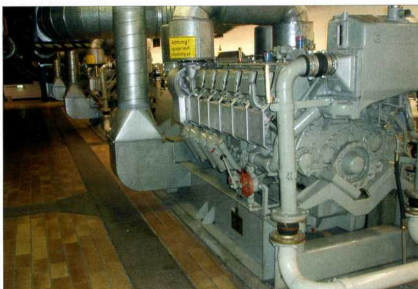
Bild 8: Für den Fall der Fälle – Vier mtu-Schiffsdiesel mit je rund 1.100 kVA können im Notfall Strom liefern.
