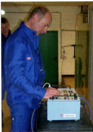
Bild 7: Test der Überwachungseinheiten der Kries-Energietechnik durch primärseitige Schutzprüfung eines IKI-30 Trafomonitors mit Messung der Auslösezeit.
