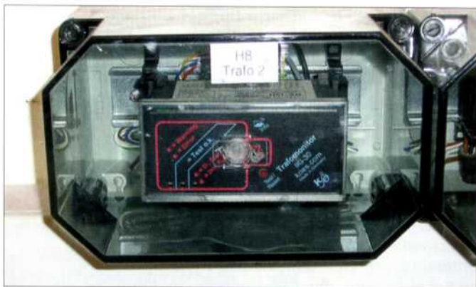
Bild 4: Das IKI-30 von Kries-Energietechnik ist eines der kompaktesten digitalen Schutzrelais gemäß IEC 60255. Zur Nachrüstung in älteren Anlagen ist das Relais extern angebracht und durch das Kunststoffgehäuse geschützt.
