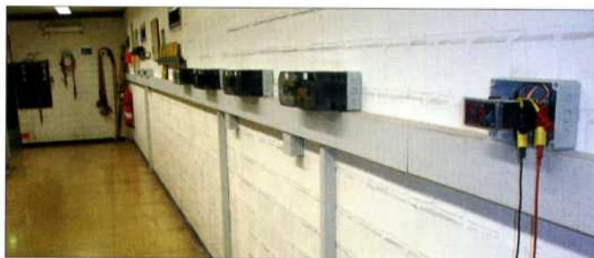
Bild 5: Für eine intelligente Überwachung der Transformatoren nach IEC 60255 sorgen die digitalen Trafoschutzrelais IKI-30E. In Kombination mit den Leistungsschaltern bieten sie sicheren Schutz vor Überstrom, Kurzschluss oder Erdkurzschluss. Da die alte MS-Anlage nicht über Fronttafeleinbauplätze in einer integrierten Sekundärtechniknische verfügte, wurden die IKI-30 in Kästen an der gegenüberliegenden Wand angebracht. Die Verkabelung ist in Kabelkanäle untergebracht.
