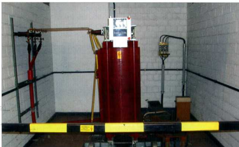
Bild 1: DB Energie betreut als unabhängiger Energiemanager der Bahn eines der größten energieartenübergreifenden Portfolios in Deutschland. Im Bild einer von mehreren Gießharz-Transformatoren im Hauptbahnhof Frankfurt mit je 1000 kVA.
