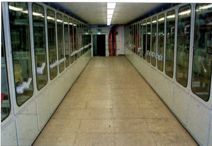
Bild 6: DB Energie verfügt über eine leistungsfähige Infrastruktur zur Stromversorgung von mobilen und stationären Verbrauchern. Blick auf einen kleinen, älteren Teil der Niederspannungshauptverteilung im Hauptbahnhof Frankfurt.
