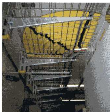
Weil im Doppelboden der Serverschränke die Kühlwasserleitungen untergebracht sind, wurden die Datenleitungen oben verlegt.
