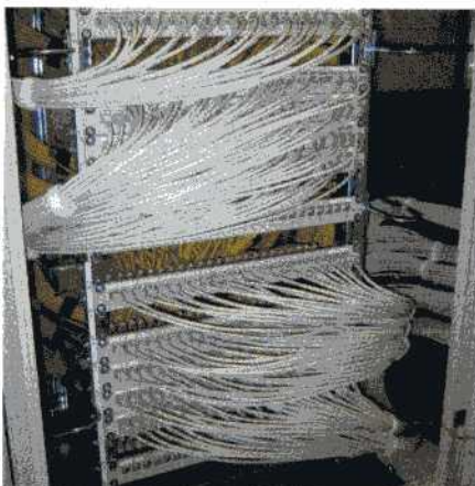
Eine saubere Kabelführung mit Beschriftung erleichtert die Orientierung. Telegärtner lieferte das AMJ-Modulsystem und konfektionierte die Kabel.
