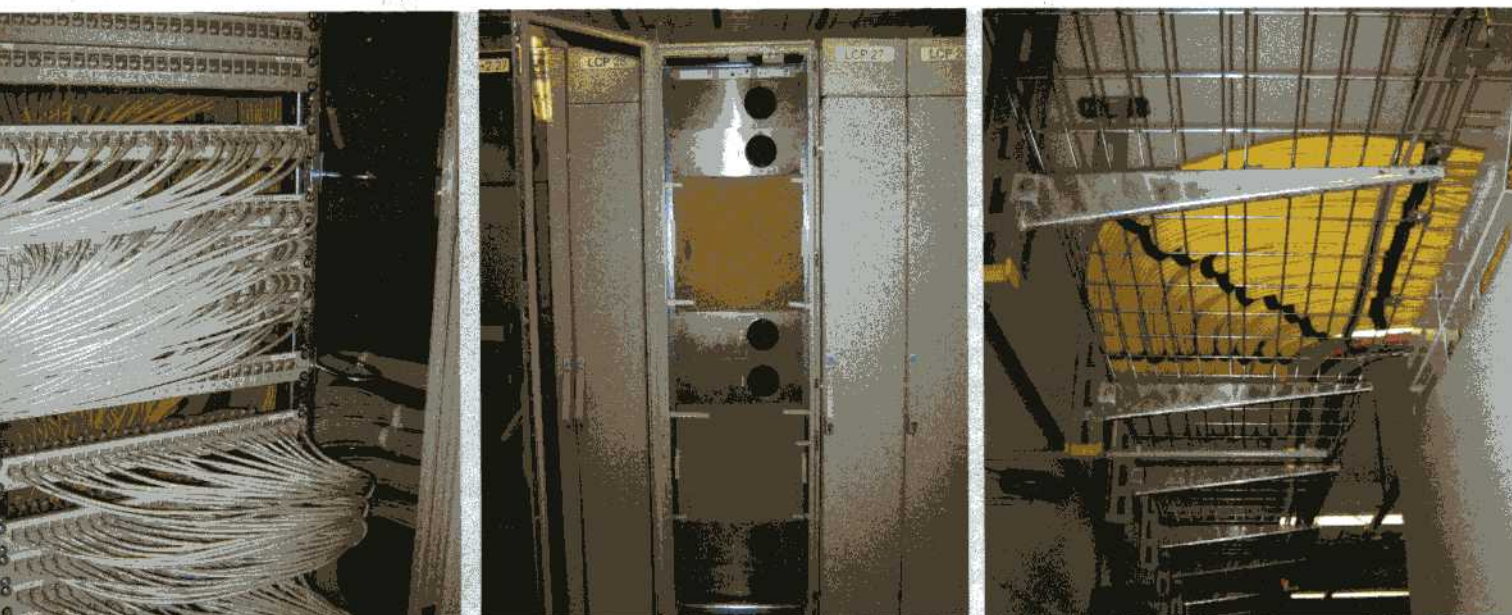
Eine saubere Kabelführung mit Beschriftungen erleichtert die Orientierung. Telegärtner lieferte das AMJ-Modulsystem und konfektionierte Kabel just in time.
