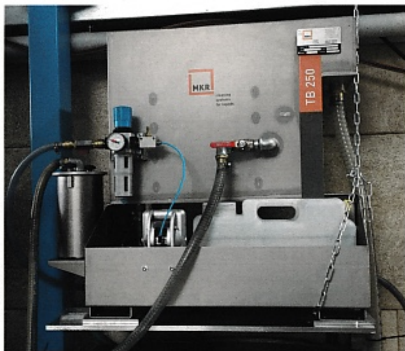
Die drei Fremdölabscheider TB 250 von MKR Metzger arbeiten energieeffizient nach dem Koaleszenzprinzip. Weil sie im Bypass-Modus bei laufender Maschine oder Anlage funktionieren, entstehen keinerlei Stillstandzeiten. Und durch den hohen Abscheidungsgrad verlängern sich die Standzeiten der Kühlschmierstoffe erheblich.
