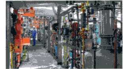
Digitale Anlagendokumentation: Bilfinger-Cloudlösung kommt jetzt bei Mittelständler im Chemiapark zum Einsatz. Seite 09
