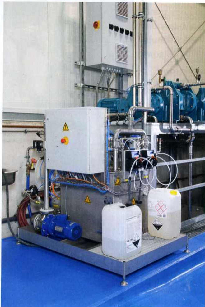
Bild 9: Dosierstation für die Reinigungsmedien
