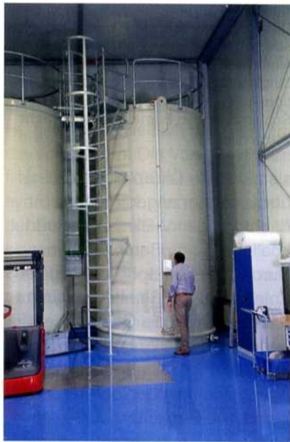
Bild 5: Gesteuert und überwacht wird der gesamte Vorgang durch eine Software
