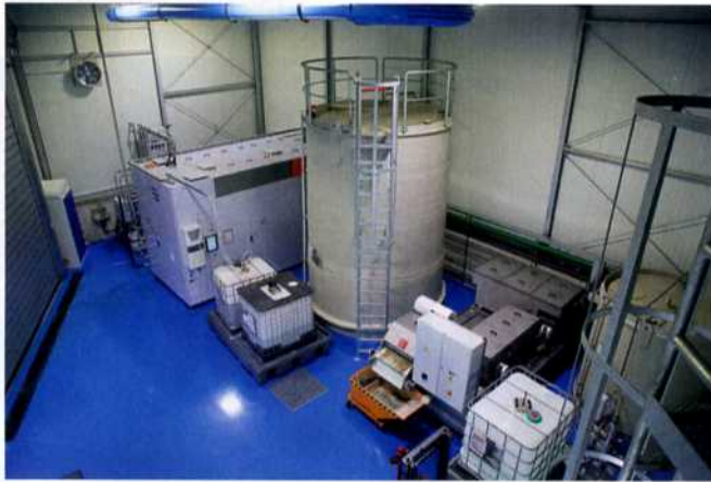
Bild 1: MKR Metzger hat für RUAG das beste Gesamtpaket einer Verdampferanlage geliefert
