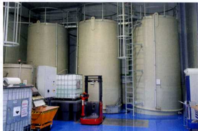
Bild 4: Gesammelt wird das zugeführte Prozesswasser zunächst in drei 24 m 3 fassenden Rundbehältern
