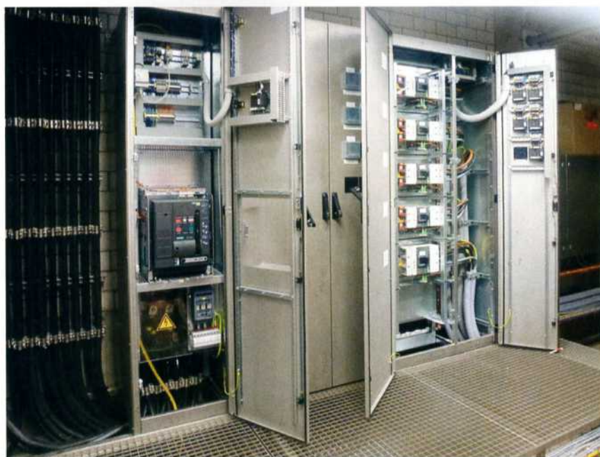
Bild 3 | Besondere Herausforderung an das Wärmemanagement: Die absolut dichte Vamocon-Anlage in Edelstahl in der Station Eiswasser.
