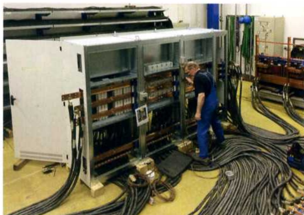
Bild 2 | Für die Prüfungen der Vamocon Niederspannungs-Schaltanlagen beim IPH sind umfangreiche Vorbereitungen notwendig.
