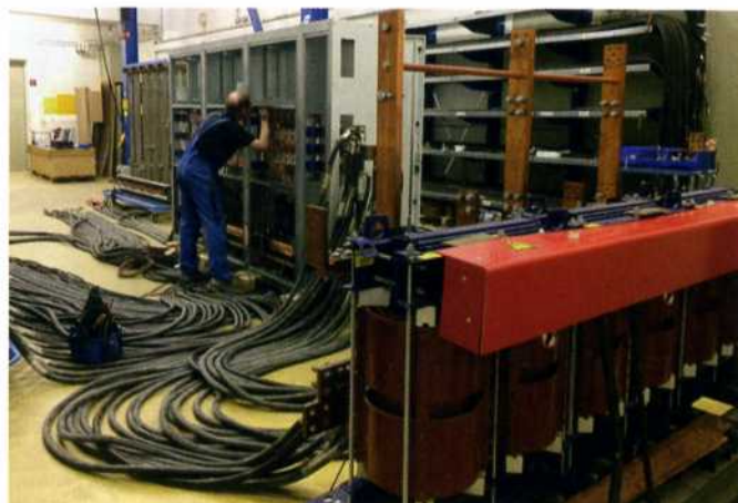
Bild 3 | Bei Sedotec wird auch die kritischste Geräteanordnung definiert und geprüft.
