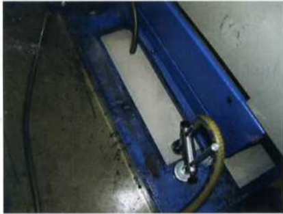
Bild 6: Die Fremdölabscheidung mit dem TM450UV läuft im Bypass-Verfahren während des Maschinenbetriebs
