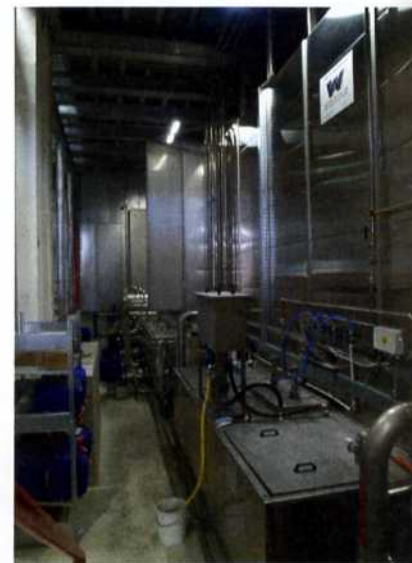
In der GSB-konformen Vorbehandlungsanlage können Stahl- und Aluminiumteile sowie verzinkte Teile vorbehandelt werden.
