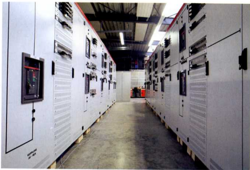
Bild 2 | Mit den Vamocon-Anlagen ihres Partners Sedotec hat die Firma Carl Elektro-Anlagen ihren Umsatz im Geschäftsbereich Niederspannungsschaltanlagen mehr als verdoppelt.
