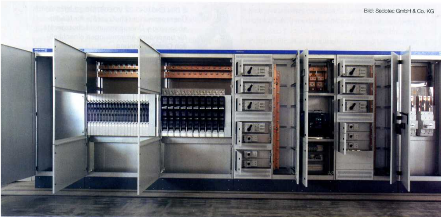
Bild 1 | Kunden erwarten Produkte, die den neuesten Normen und Sicherheitsanforderungen entsprechen. Vamocon-Niederspannungsschaltanlagen verfügen über Bauartnachweise gemäß DIN EN61439 für Schaltgeräte von ABB, Siemens, Schneider Electric, Mitsubishi, Jean Müller, Efen und Wöhner.
