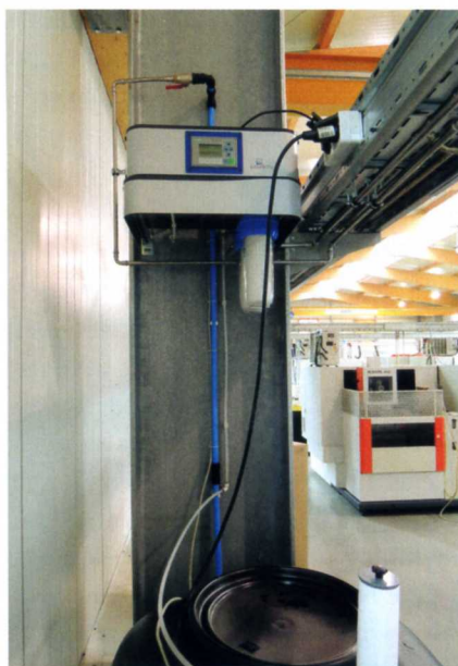
▲ Über ein zentrales Leitungssystem werden die Draht-Erodiermaschinen mit bis zu 2.400 Liter aufbereitetem Prozesswasser pro Tag versorgt.
