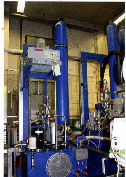
Wichtiger Bestandteil und ein Grund für die günstige Betriebskostenstruktur der Gesamtanlage ist die Hydraulikeinheit von Bott, die eine hydrodynamische Rotorlagerung der Welle ermöglicht
