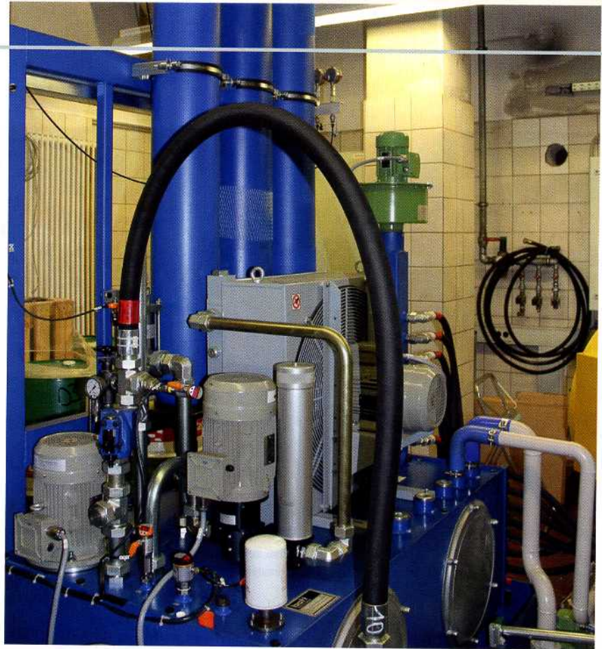
Zwei Hydraulikaggregate mit insgesamt 700 l Ölinhalt versorgen die Anlage. Gut erkennbar sind die schlanken hydropneumatischen Druckspeicher, die die Lagerstellen auch bei Stromausfall schnell und sicher mit Schmieröl versorgen
