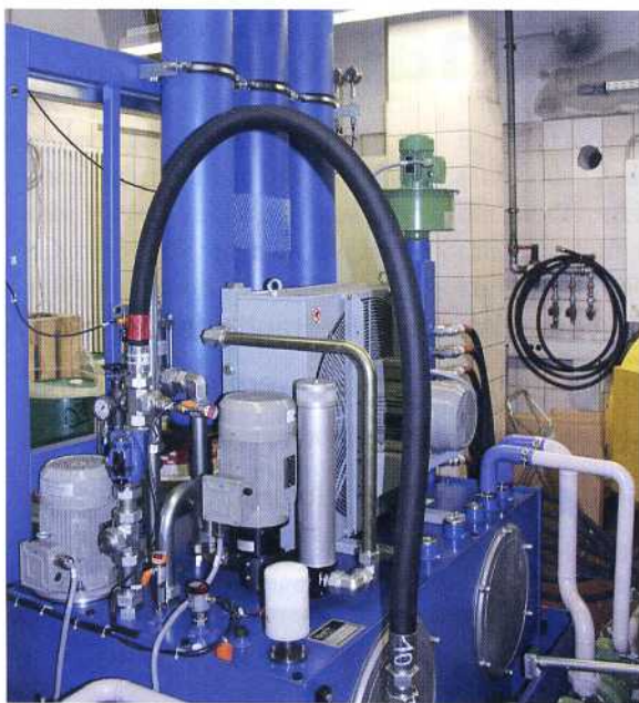
Hydraulikanlage von Bott: vorne unten die zwei Hydraulikaggregate mit 700l Ölinhalt, hinten stehend drei der vier Druckspeicher für den Notfall.
