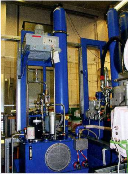
Die Hydraulikspezialisten von Bott entwickelten eine Lösung, bei der die Welle hydrodynamisch gelagert ist. Hydropneumatische Druckspeicher versorgen die Lagerstellen auch bei Stromausfall blitzschnell und sicher mit Schmieröl
