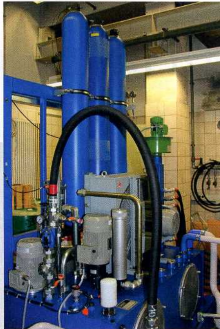
Zwei Hydraulikaggregate mit insgesamt 700 l Inhalt versorgen die Anlage mit Öl, um alle Lagerstellen der berührungslos gelagerte Präzisionswelle zu schmieren
