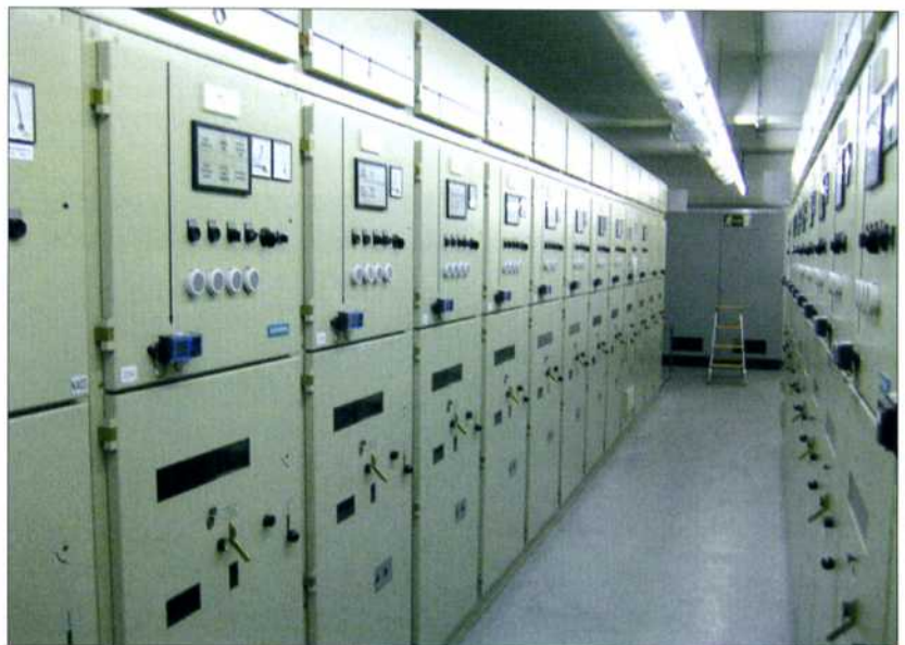
Bild 2: Als Betreiber des Großflughafens verfügt Fraport über ein eigenes Mittelspannungsverteilstromnetz mit vier Umspannwerken und mehr als 500 Transformatorstationen in etwa 170 Schaltanlagen.
