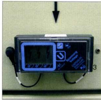
Bild 1: Die Umstellung auf Span-nungsprüfsysteme Capdis-PI von Kries-Energietechnik spart der Fraport AG teure und zeit- und personal-intensive Wiederholungsprüfungen.
