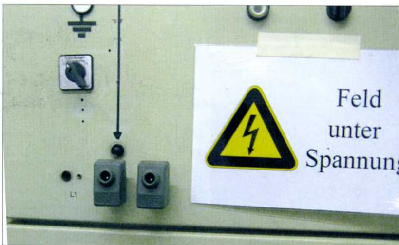
Bild 5: Früher wurden SF 6 -isolierte Schaltanlagen eingesetzt, die teilweise mit steckbaren, kapazitiven hochohmigen Spannungsprüfsystemen versehen waren.
